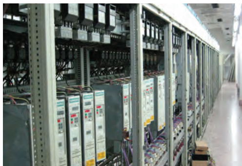
作者: 王玉广 单位: 宝钢股份冷轧厂 品牌: SIEMENS-西门子 型号: 6SE70变频器 应用领域: 冶金 采购/使用年份: 1999年 应用单位: 宝钢冷轧连续机组 控制用途: 连续运行机组的辊子传动 在用数量: 128 上传时间: 2007-12-9
